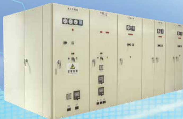
■ 屋内形キュービクル
